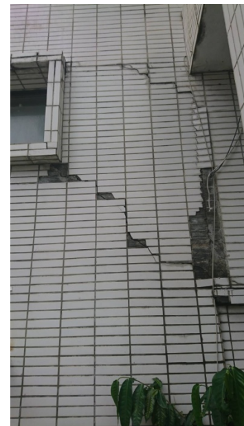
結構損壞-明義國小明義樓
